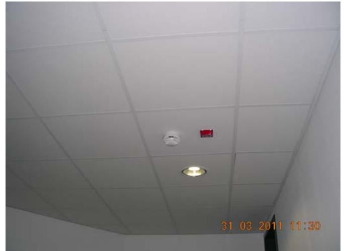
OWA-Decke Bereich Finanzamt
