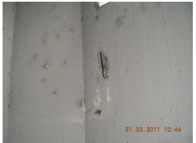
Leichte Abplatzungen im Treppenhaus
