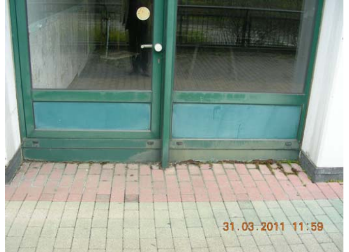
Türelemente Läden Südwestseite - unten stark angerostet
