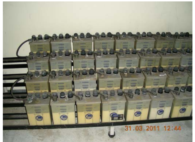
Batterieraum Laden Basement
