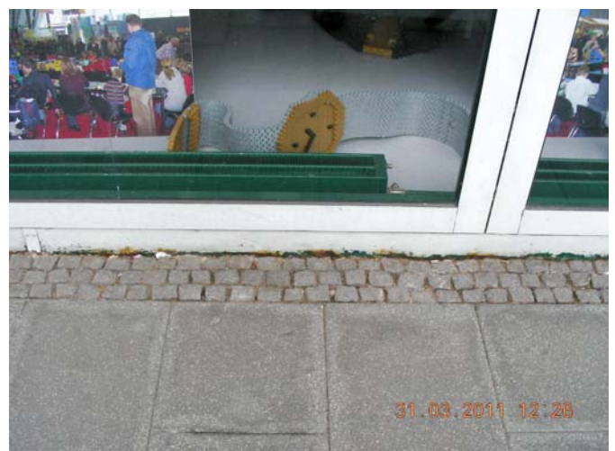
Fenster unten angerostet
