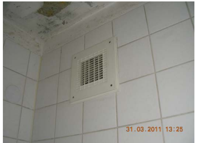
Badlüfter leerstehende Wohnung
