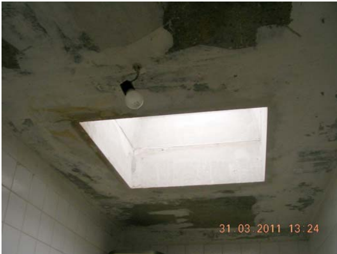
Bad leerstehende Wohnung
