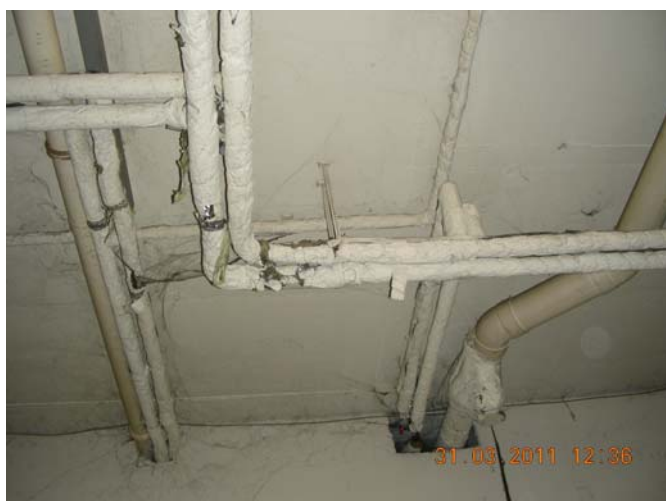
Isolierung stark beschädigt
