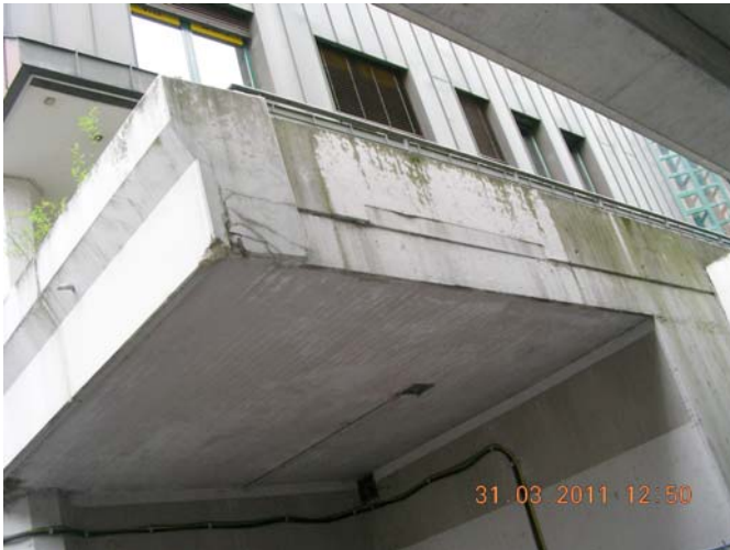
Schäden - Anlieferungsbereich vermutlich durch LKW
