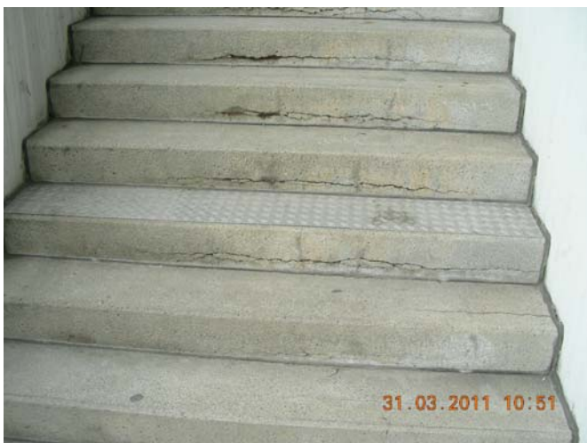
Treppenstufen mit Schäden
