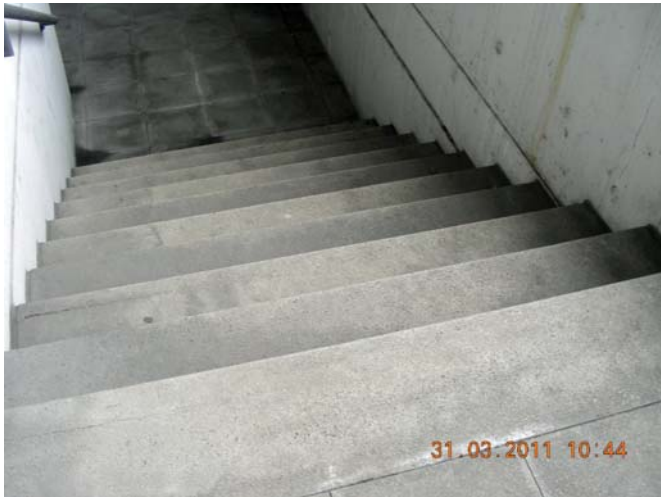
Treppenstufen mit Schäden
