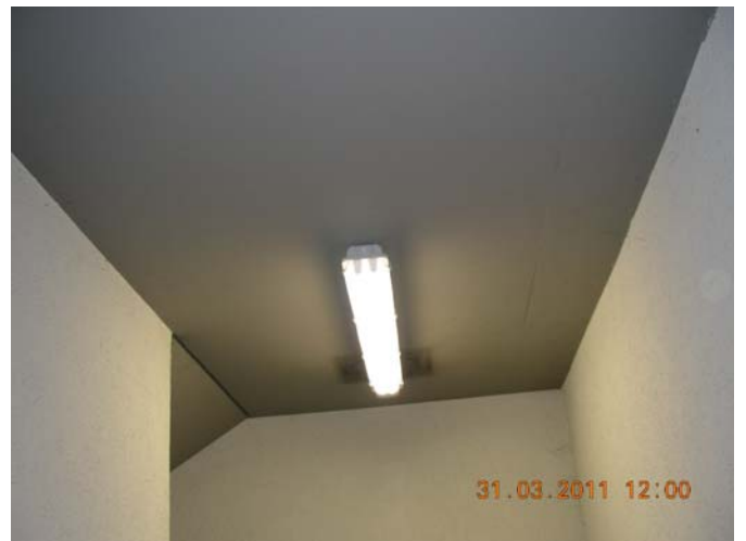
Nachgerüstete Leuchte im Treppenhaus
