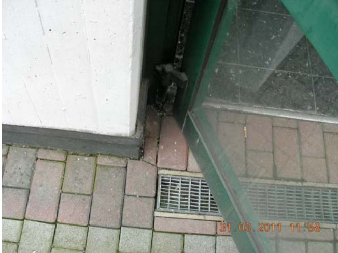
Türe Treppenhaus beim FA - Fuge Verwahrung offen
