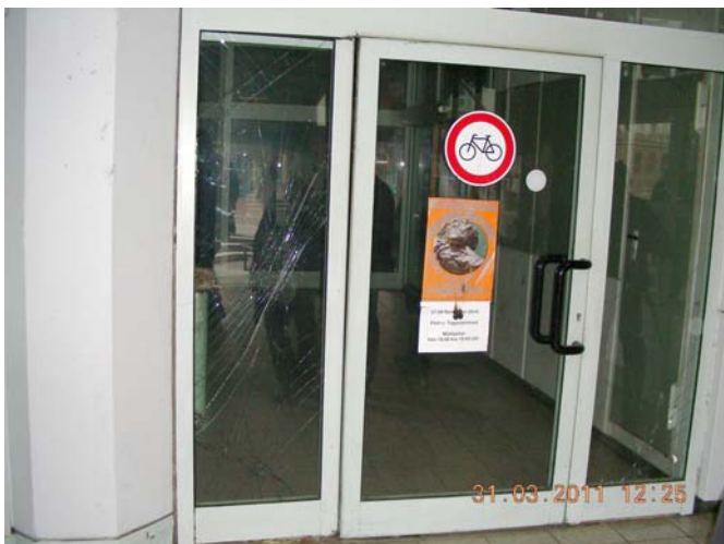
Türen und Scheiben beschädigt
