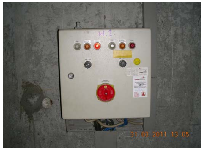
Hebeanlage steht auf Störung
