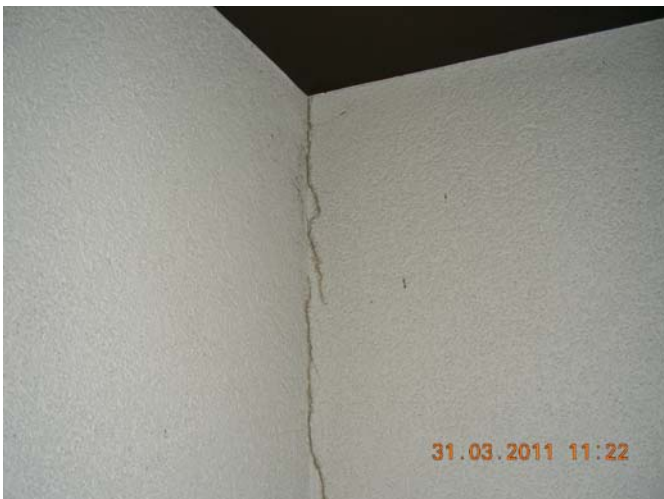
Alter Riss im Foyer
