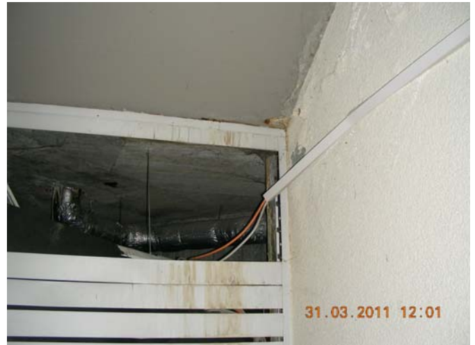
Undichte Stelle unter Treppenhaus beim FA
