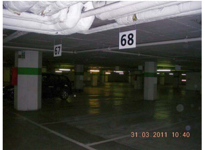
Leitungen an Tiefgaragendecke
