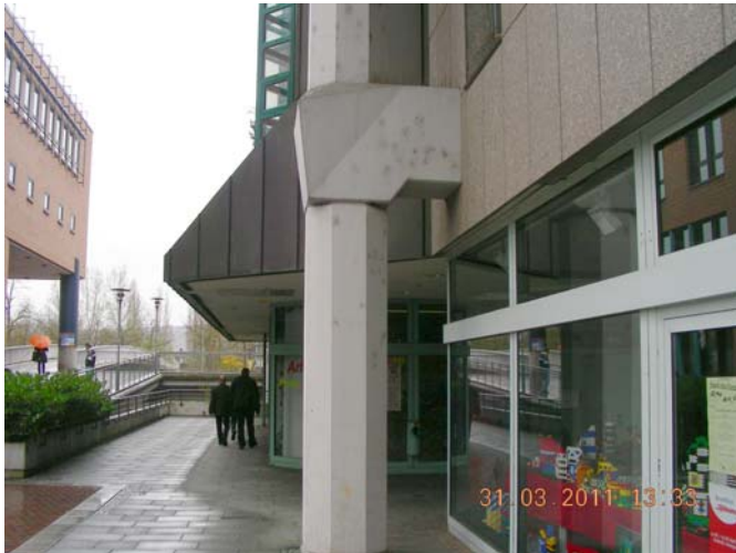
Aussenstützen - Wärmebrücken / Ostseite
