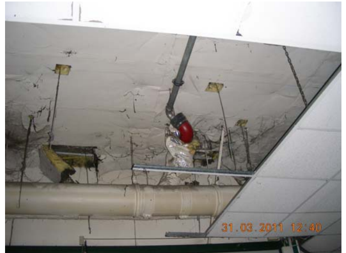
Leitungen unter der Decke
