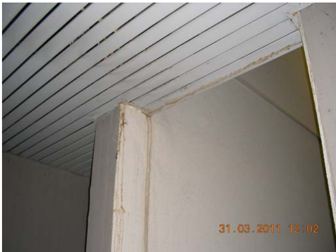
Undichte Stelle unter Treppenlauf
