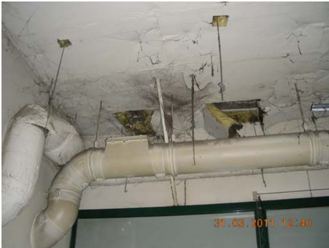
Leitungen unter der Decke
