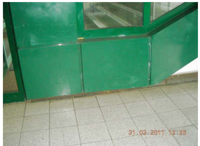
Fensterelemente unten stark angerostet
