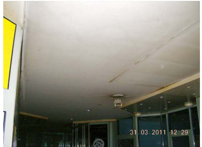
Decken Mallbereich - starke Gebrauchsspuren
