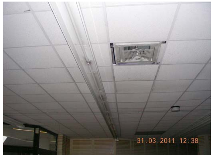
OWA-Decken Laden Basement
