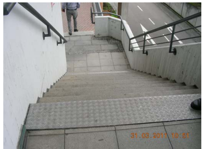
Treppenstufen - mit Blech gesichert
