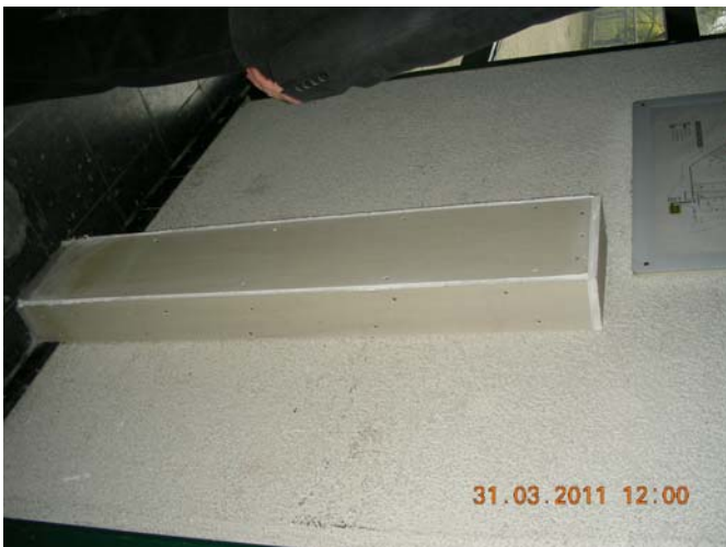
Verkleidung Leitungen im Treppenhaus
