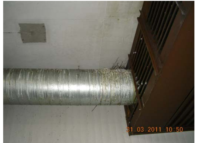
Lüftungsrohr im UG
