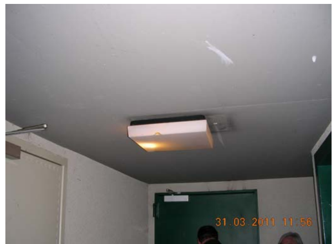
Beleuchtung Treppenhaus sehr schwach
