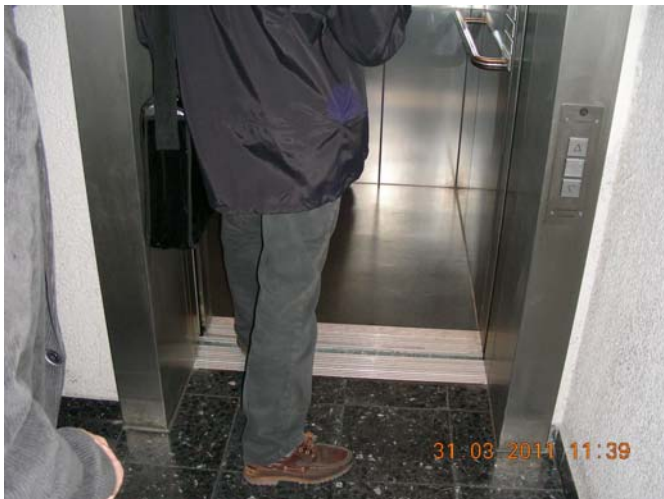
Aufzug Treppenhaus FA
