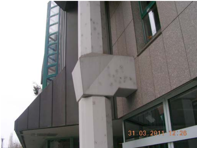
Außenliegende Stützen - sind Wärmebrücken
