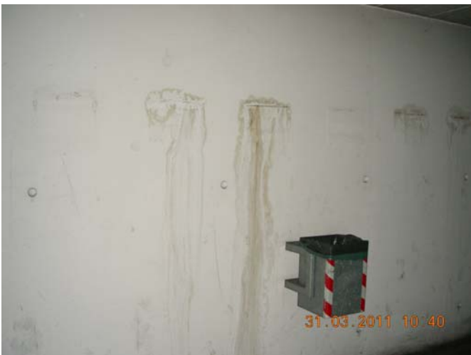
Alte Undichtigkeiten in TG
